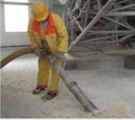
Aspirazione di cemento
