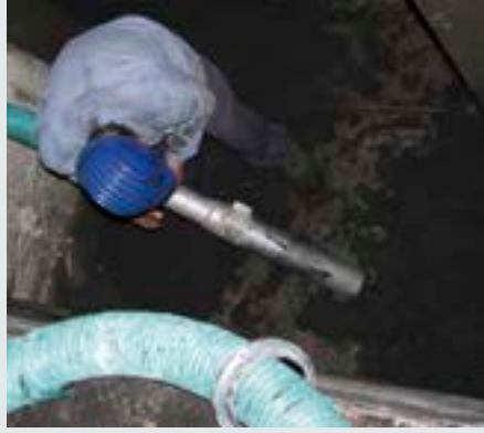
Aspirazione di sabbia di fonderia da cunicoli
